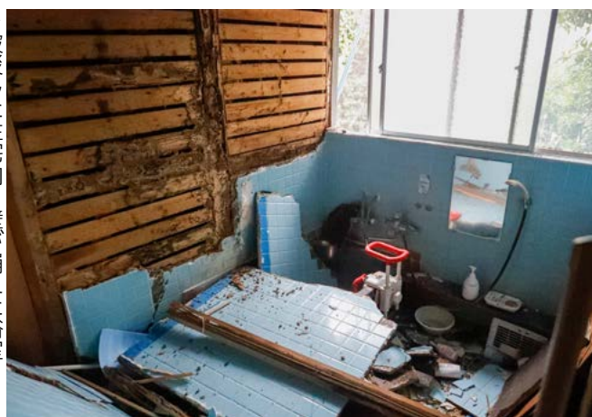
▶被災した住宅内 壁が崩れた浴室
