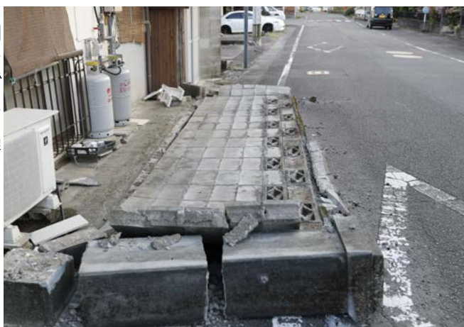
▶倒れたブロック塀
