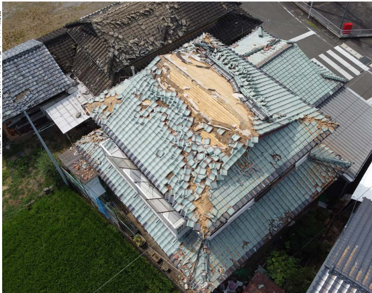
▶地震により瓦が落ちた住宅 ドローンで撮影
