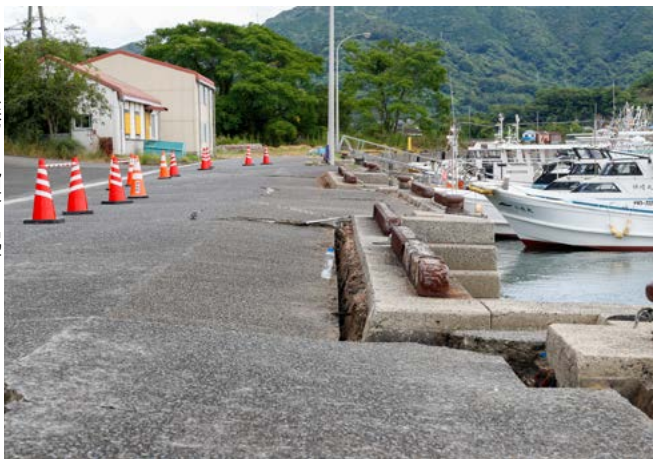
▶田浦漁港 亀裂と沈下
