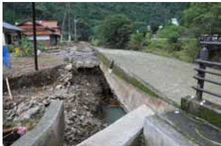
7月12日豪雨災害 床上床下浸水をはじめ河川や道路、農地などに甚大な被害が発生
