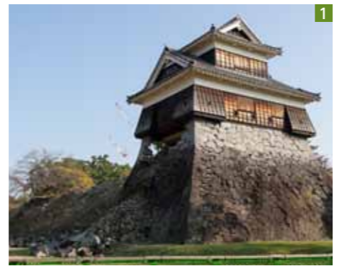
1_複数の箇所で見られる石垣の損壊(写真は戌亥櫓) 2_修復中の熊本城を案内するボランティアガイド 3_同じ位置に復元するため整理された崩れた石垣
