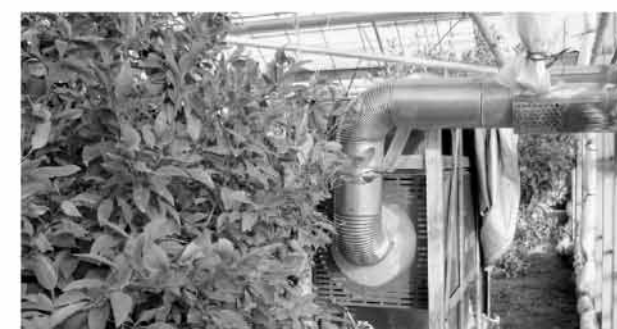
重油を多く使用するハウスボイラー設備
