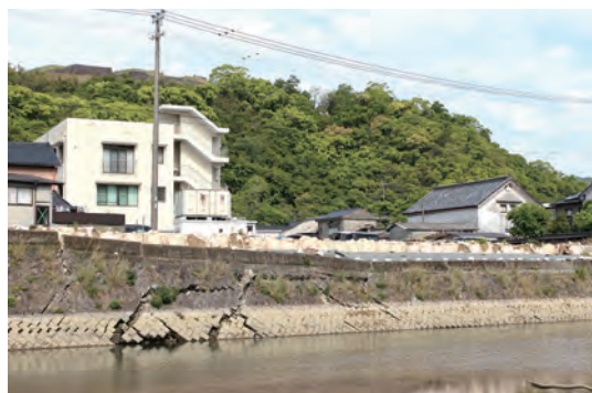
佐敷川の護岸崩壊現場
