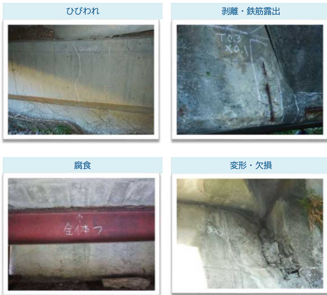
図-5 橋梁の主な損傷例
