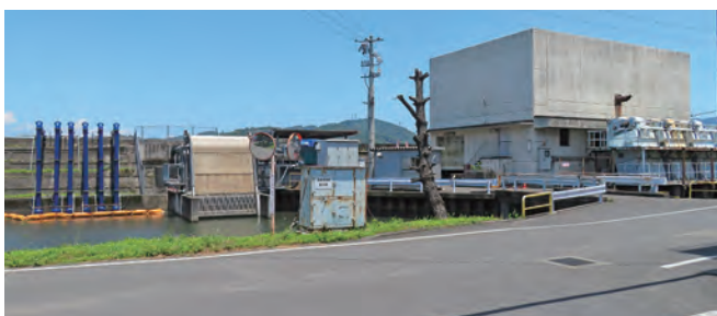
小田浦排水機場【東海カーボン(株)田ノ浦工場敷地内】 芦北町設置（左）・熊本県設置（右）
