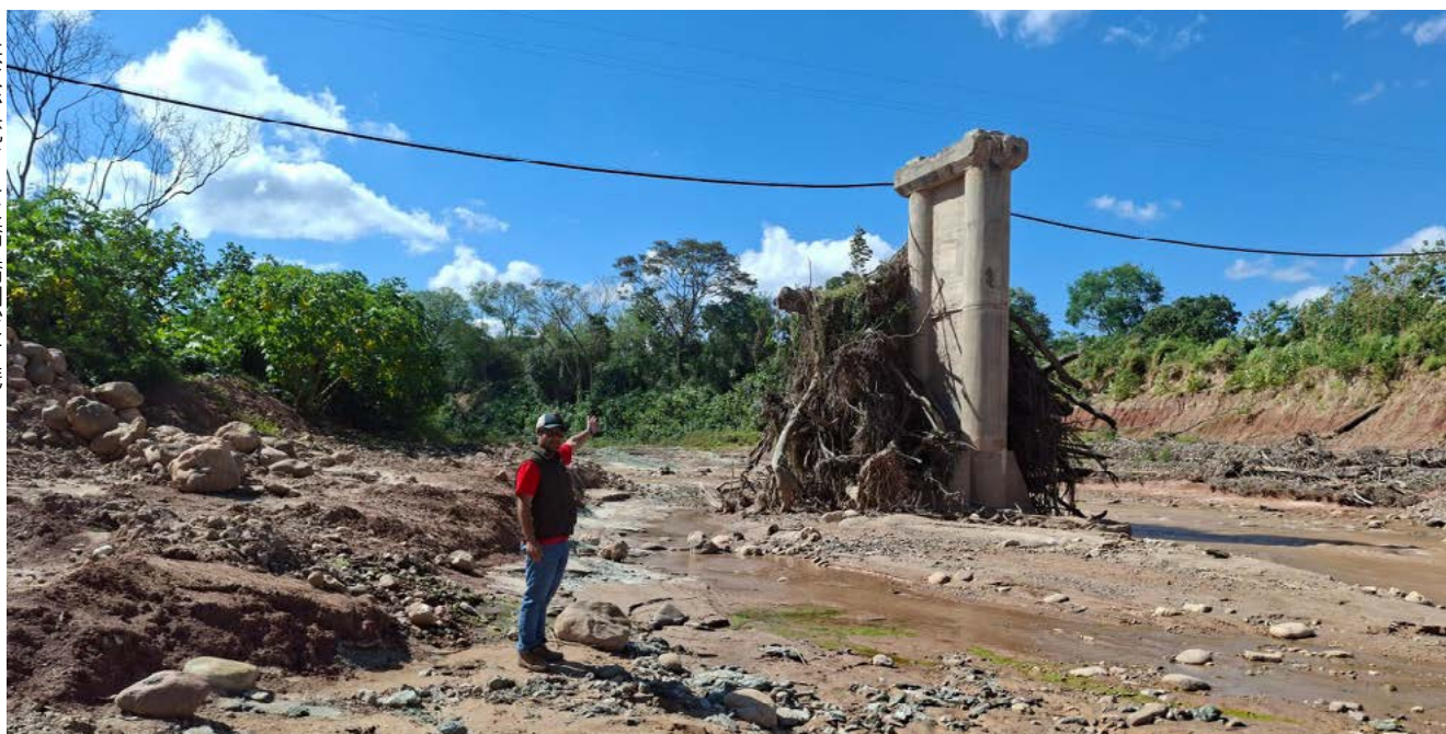
▶ 洪水で流された橋 橋脚だけ残る
