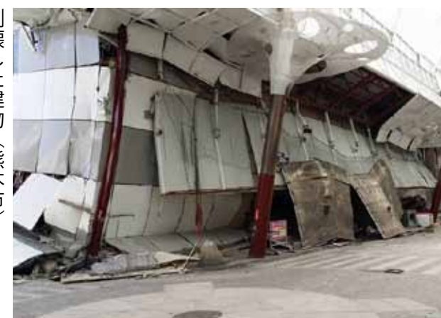
倒壊した建物（熊本市）
