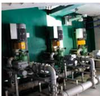
花岡浄水場送水ポンプ
