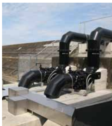
小田浦排水機場（平成22年）
