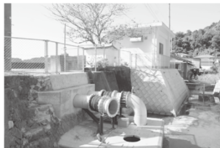
泊地区排水ポンプ
