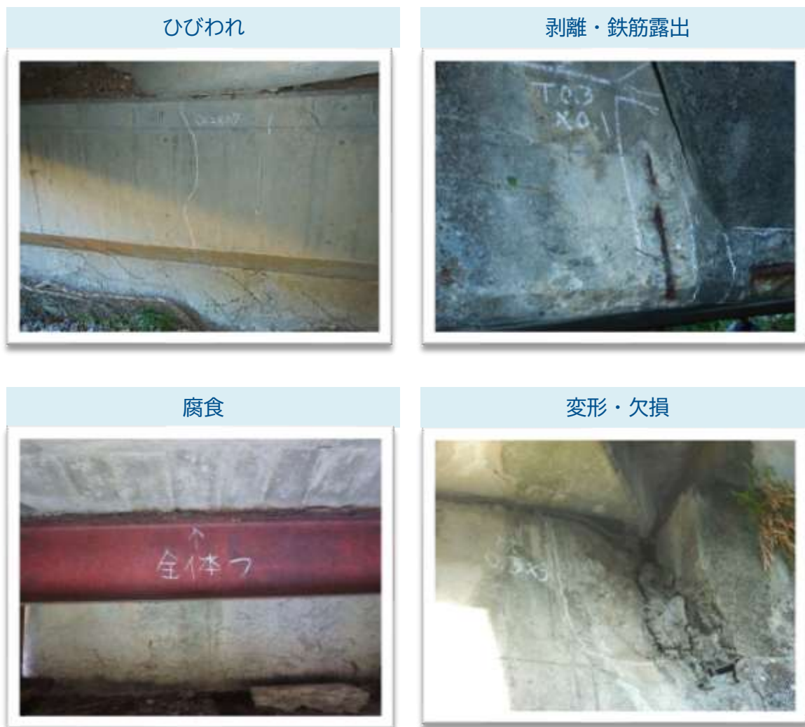
図-5 橋梁の主な損傷例
