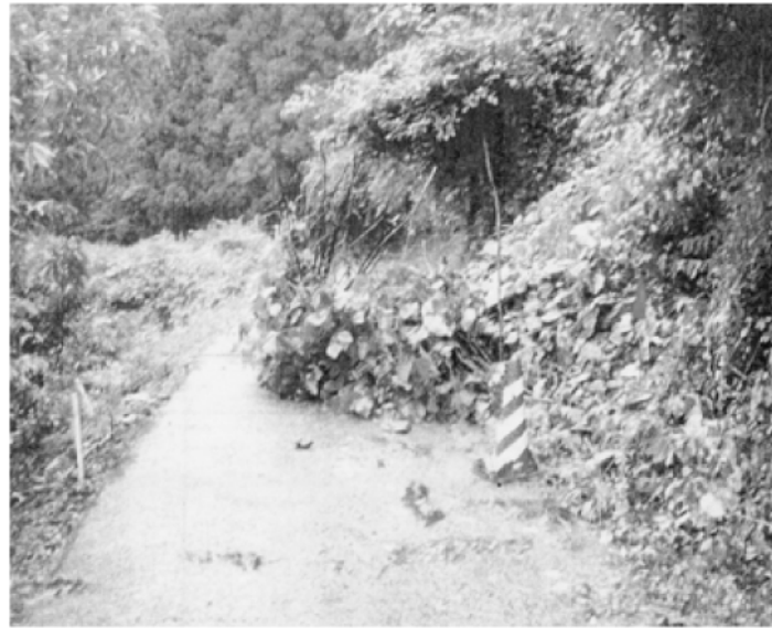
町道尾白線の土砂崩壊現場（告地区）
