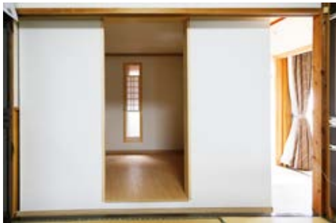
▲耐震シェルター正面 強度を保つため大きい開口部は1箇所、内部の広さは4.62㎡
