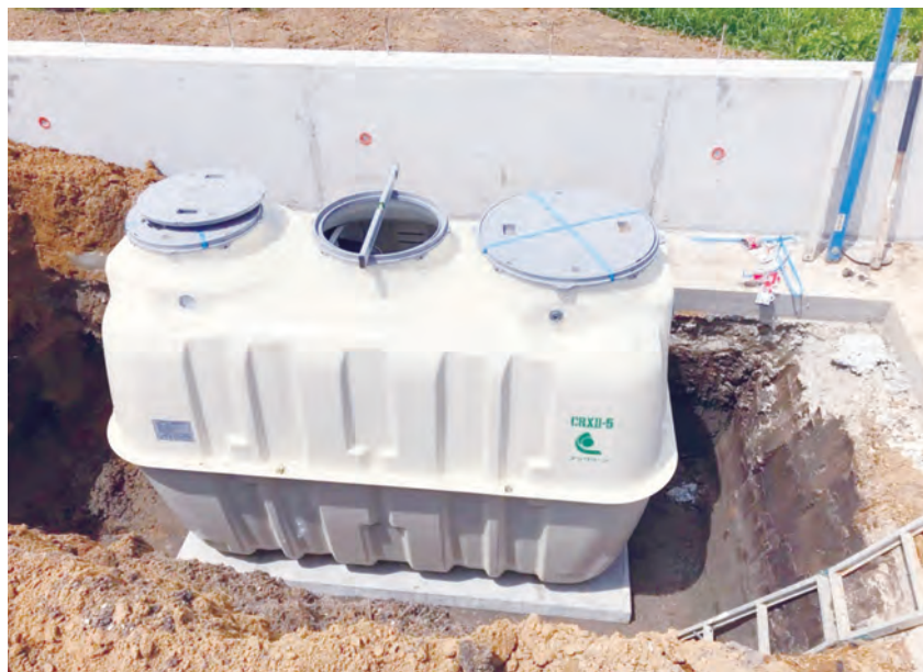
合併処理浄化槽(下水道)
