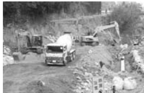
大野天月「町道小口2号線」の災害復旧
